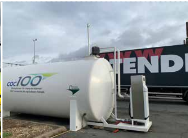
Cuve de biocarburant B100.
